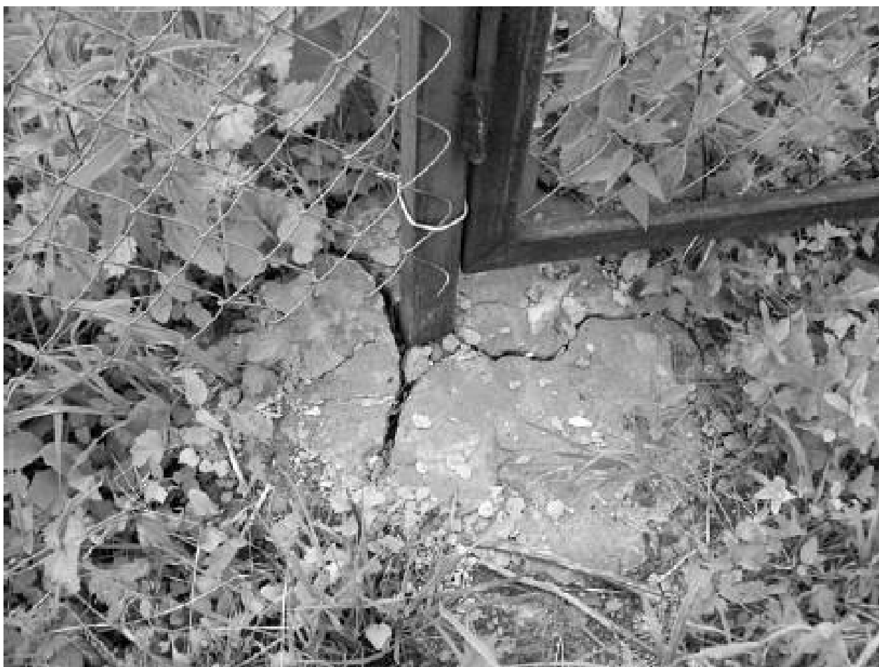
Рис. 6.4. Плохое качество бетонирования основания опорного столба
