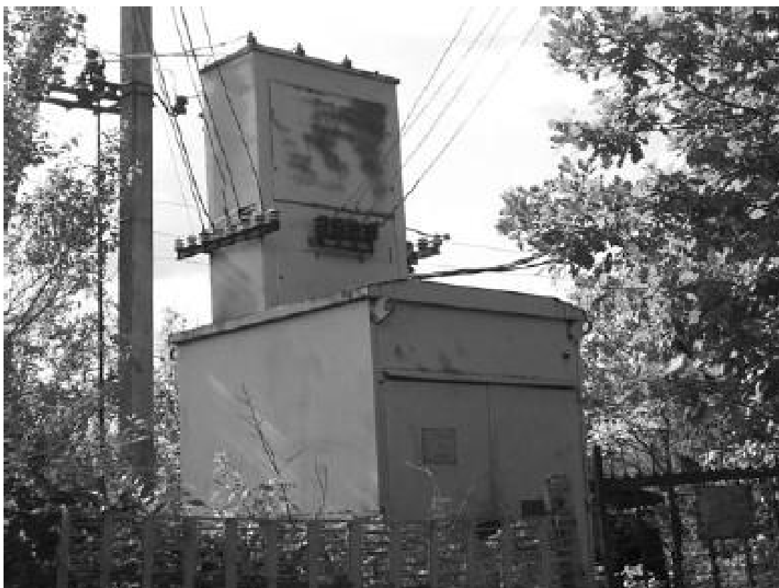
Рис. 1.14. Трансформаторная подстанция в дачном поселке
