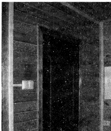
Рис. 4.24. Проводка в кабель-каналах
