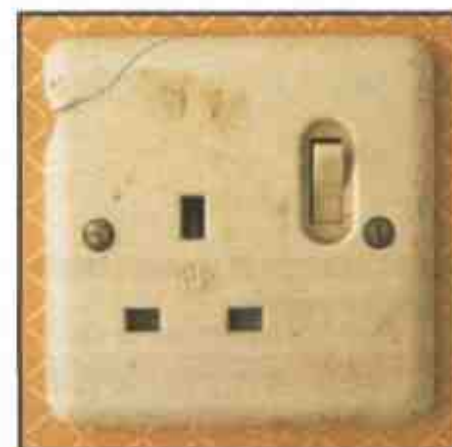
Треснувшая розетка опасна
