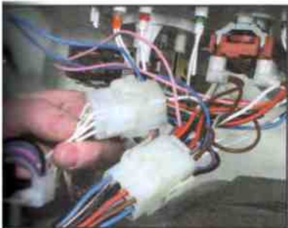
Внутренний электромонтаж очень сложный
