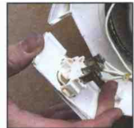
Некоторые выключатели легко заменяются
