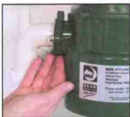
1 Не протекает ли прокладка?
