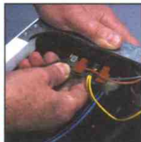
Зачистите корродированные контакты
